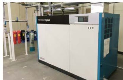
小山工場 エアコンプレッサーの集約・合理化
