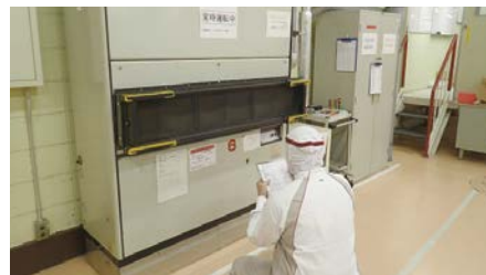
空調機点検の様子
